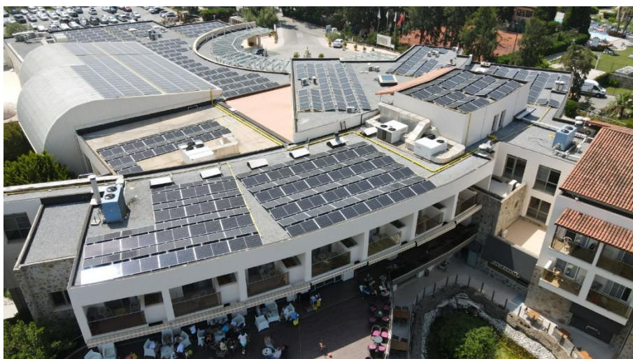
Solarmodule und elektrische Module
